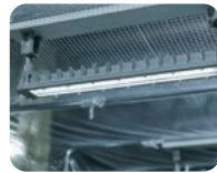
LED照明（防爆・非防爆）
